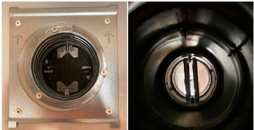
Den backventil som installerats i tidigare portar saknas i detta fall i genomförings-ventilerna mellan trapphallarna och lägenheterna enligt ingivare.
