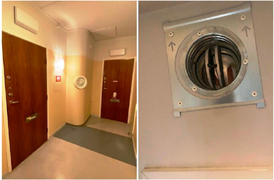
Bilder visar installationer av FTX-system på motsvarande sätt som i de första 16 portarna, utan startbesked.
