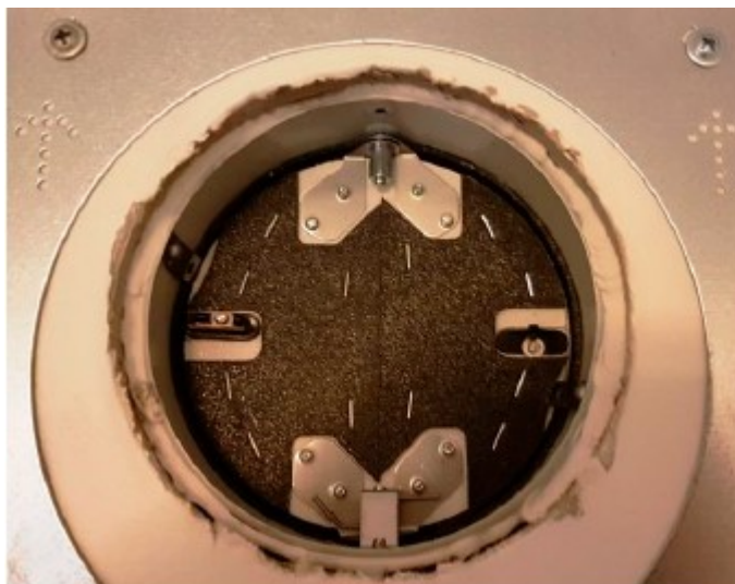
Brandspjällen har monterats med fogmassa, i strid mot tillverkarens anvisningar. Certifieringen gäller därför inte enligt ingivare.
